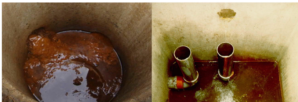
Figuur 13: Voorbeeld van een met ijzer verstoep drainagesysteem dat niet wordt onderhouden (links) en een onderhouden systeem (rechts)
