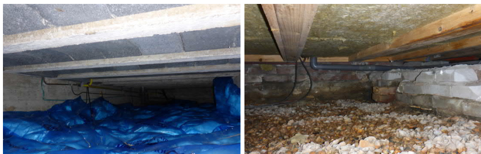
Figuur 11: Voorbeelden van kruipruimten waar bewoners zelf maatregelen hebben getroffen tegen grondwateroverlast, in Bennebroek
